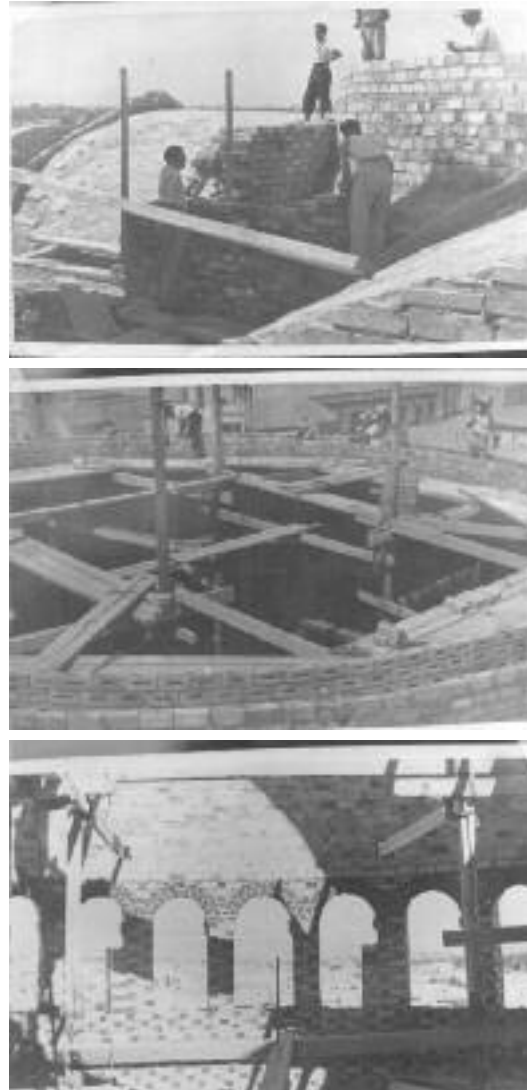
Fig. 5. Construcción de la cúpula bizantina de la Iglesia (F5.1 y F5.2) y arcos de iluminación de la nave (F5.3). Fuente: colección Antonio Serrano Bru
