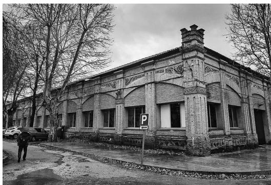
Fig. 2. El Taller de Espoletas antes de la reforma emprendida por la Oficina de Gestión de Infraestructuras (OGI) de la Universidad de Castilla-La Mancha. La Tribuna de Toledo .
