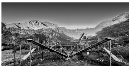
Fig. 3. Fotografía del montaje del mirador (octubre 2024). Se pueden apreciar los pilares inclinados que soportarán el elemento central del mirador. Fotografía: JRPA.
