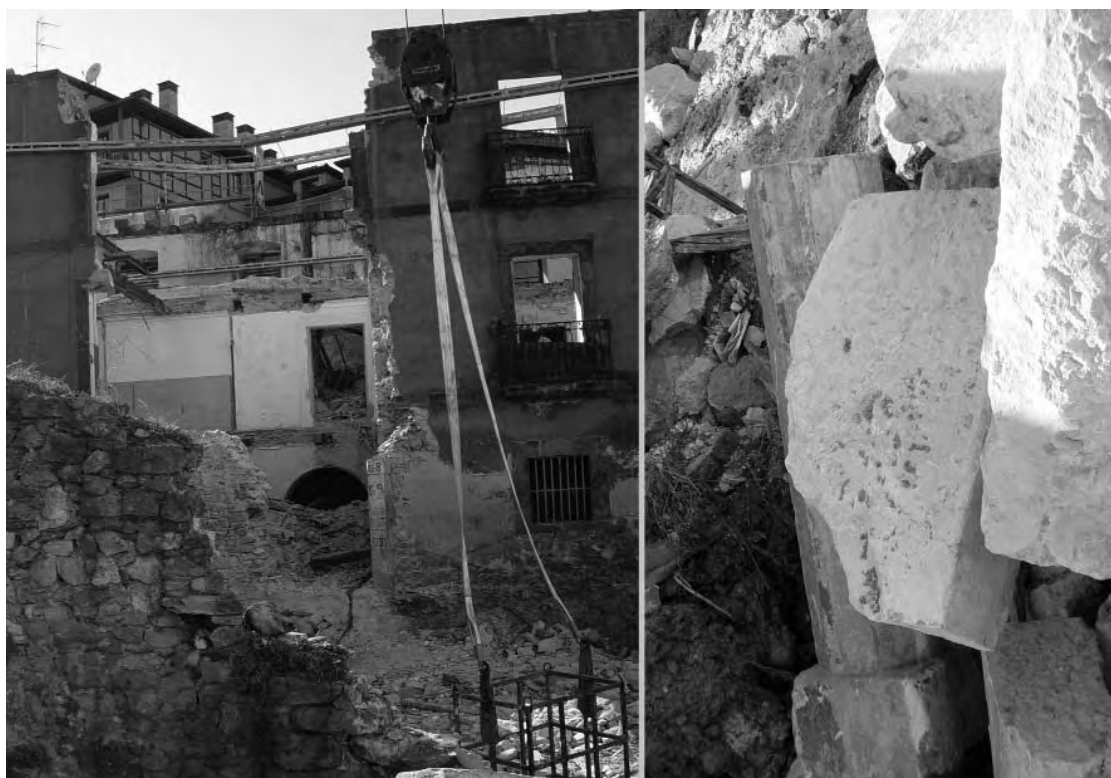
Fig. 6. A la izquierda, vista de la fachada sur parcialmente derrumbada. A la derecha, uno de los pilares de la loggia de esta misma fachada en el suelo. (Fotografías tomadas el 9 de agosto de 2007).
