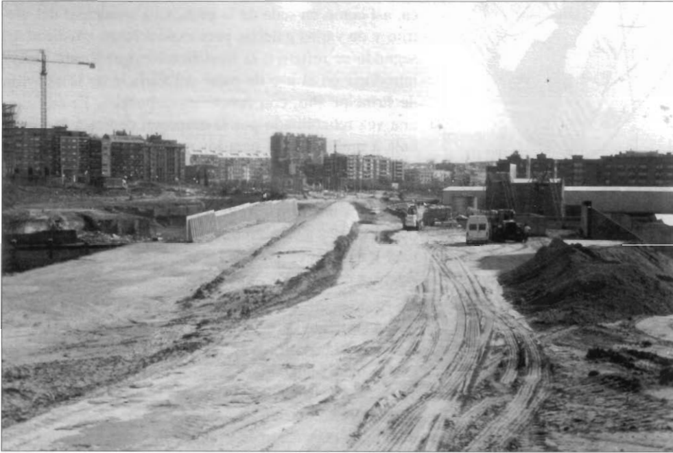
FIG. 12. Obras del tramo central del Pasillo Verde, entre el P o de las Acacias y Peñuelas. En ambas márgenes se sitúan los terrenos de las Papeleras, Madrileña y Peninsular.
