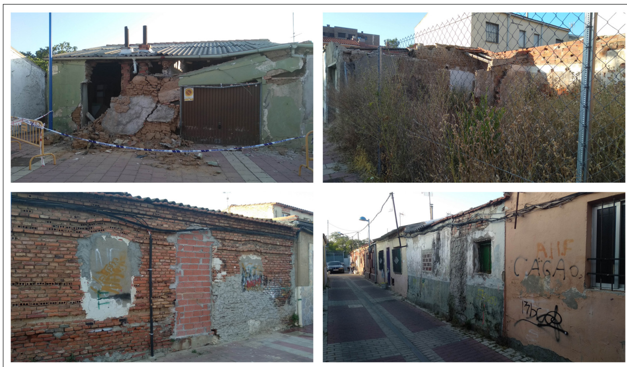
FIG. 10. Ruinas y solares abandonados en el barrio España. Fotografía: los autores, mayo de 2021.
