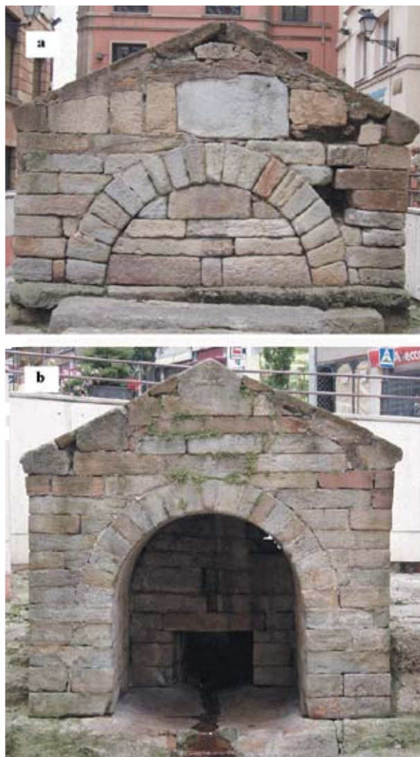
Figura 1. Fuente de Foncalada. A) Parte trasera, donde destaca la pérdida del mortero de juntas entre sillares. B) Frontal: se observan restos del mortero de juntas original (entre las dovelas del arco) y de otros morteros de aplicación posterior (próximos a la cubierta de la edificación).
