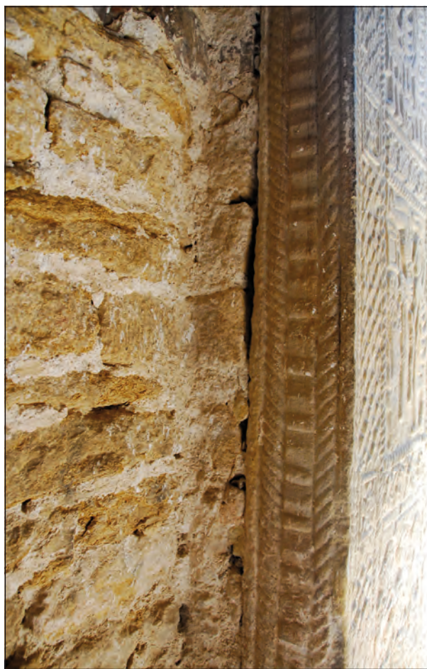
6. Junta de contacto de la jamba de Liño con el lienzo sur. Se percibe la discontinuidad en el aparejo
